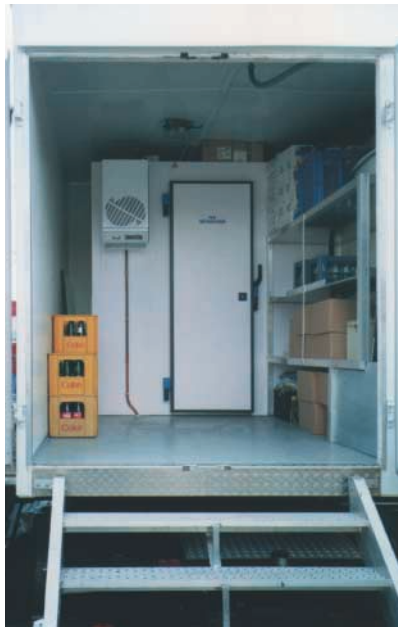
Abb. 12: Mobile Kühlzelle mit Vorraum
