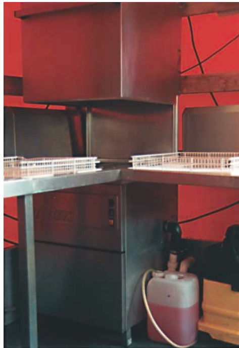
Abb. 9: Spülbereich in einem kleineren Festzelt. Spülmaschine mit automatischer Dosiereinrichtung ist empfehlenswert
